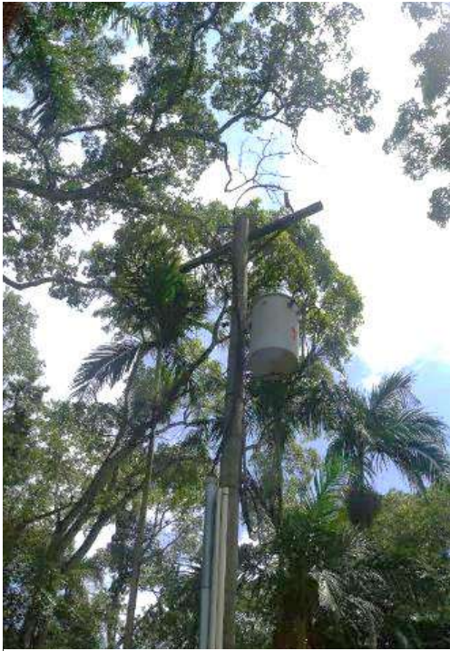
Figura 38. Poste de Luz, sistema de electricidad existente. Fuente: Plan Maestro del PMS.
