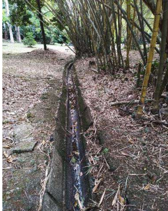
Figura 39. Alcantarillado existente dentro del terreno, mediante cunetas abiertas. Fuente: Fotografía propia
