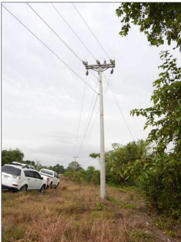
Ilustración 23: Vista de la acometida eléctrica más cercana al proyecto.
