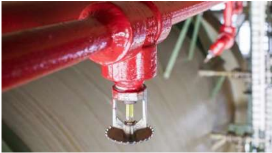
Figura 65. Sistema Contra incendio. Fuente: Internet
