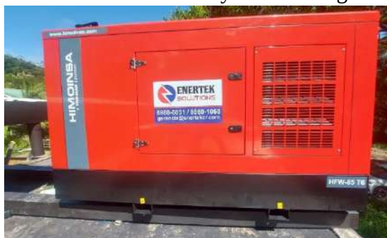
Ilustración 198: planta eléctrica. Extraído de: https://enertekcr.com/blog/conoce-las-partes-de-una-planta-electrica/
