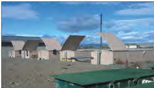
La Autoridad de vivienda de las Naciones Yakama en el estado de Washington, añadió cinco unidades AX-Max de AdvanTex® (de fondo) a sus diez unidades AdvanTex AX-100, incrementando la capacidad de su sistema de aguas residuales en un 50%. Foto cortesía de Fextex Systems, Inc.
