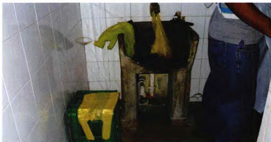
Figura 55. Lavadero en mal estado y contaminado.
