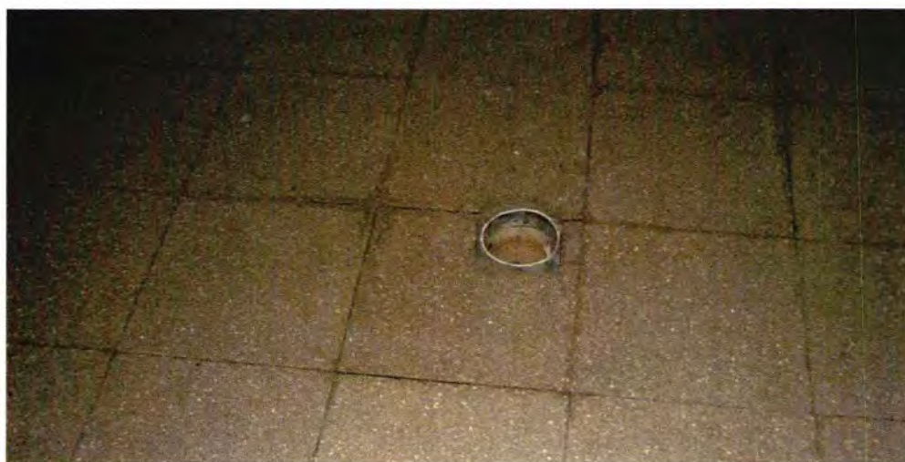
Figura 33. Falta de resumidero en la parte interna del mercado de Santiago
