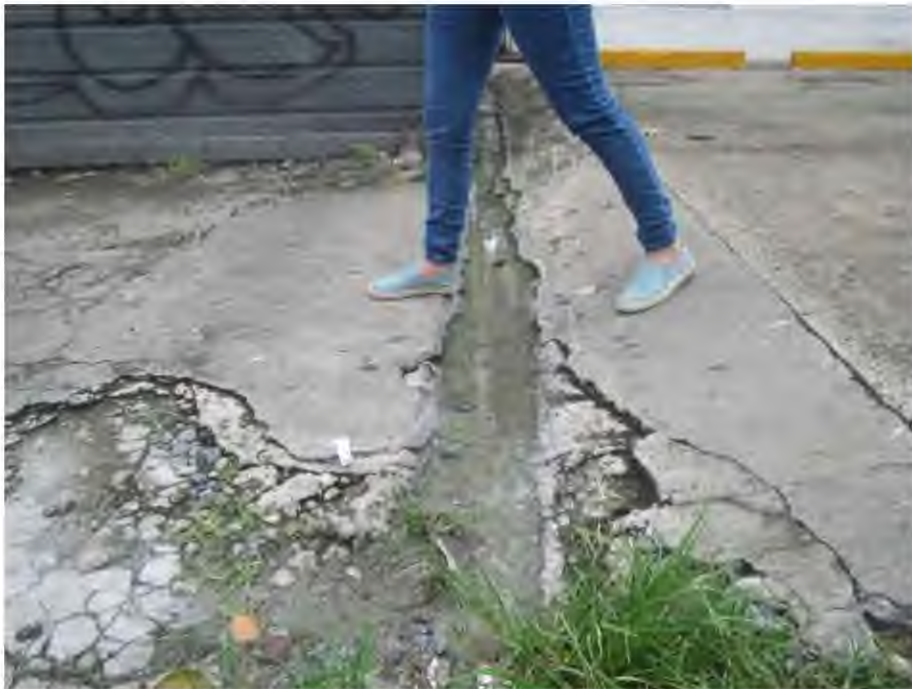
Fotografía 12. Persona evitando pisar desagüe destruido. Fuente: Dioseline Camargo
