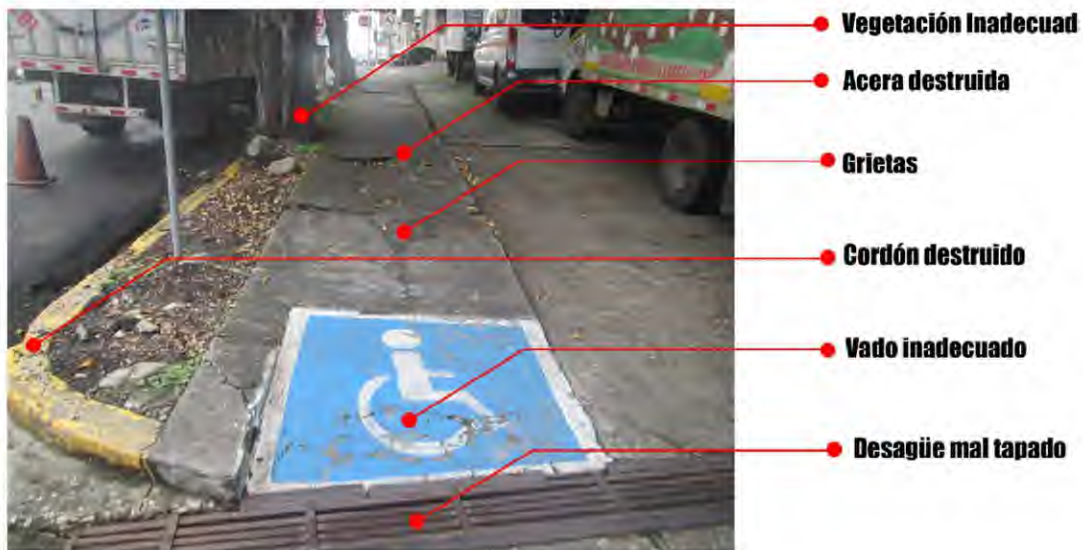
Imagen 17. Elementos y condiciones existentes en el sector crítico. Fuente: Dioseline Camargo.
