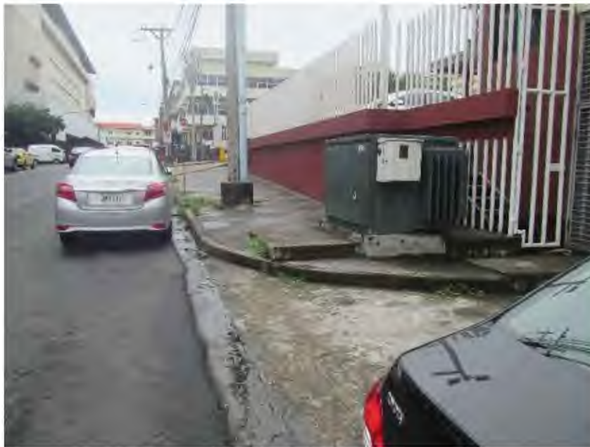
Fotografía 11. Elementos existentes, sector crítico. Fuente: Dioseline Camargo
