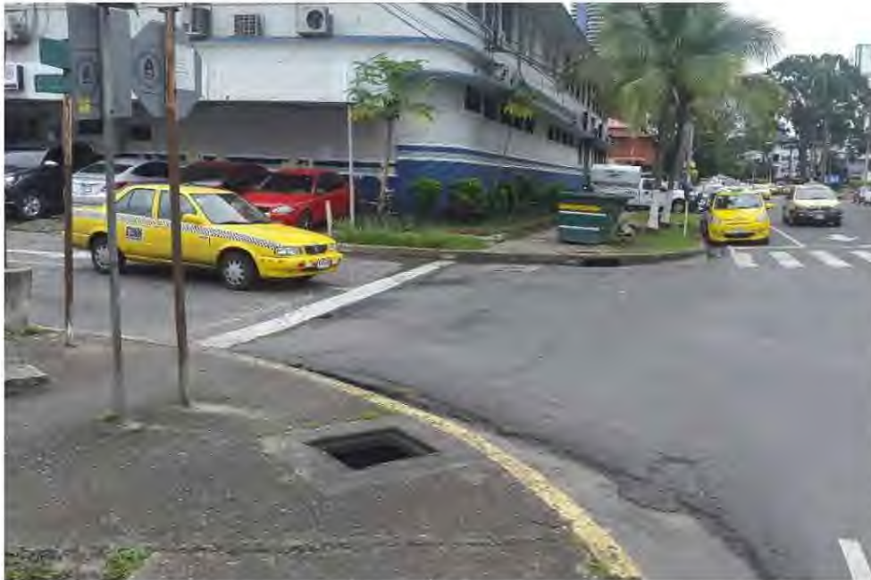
Fotografía 2. Barrio «La Exposición». Esquina de la subestación de Calidonia. Alcantarillas sin tapas y contenedor de basura obstruyendo el paso peatonal. Fuente: Dioseline Camargo
