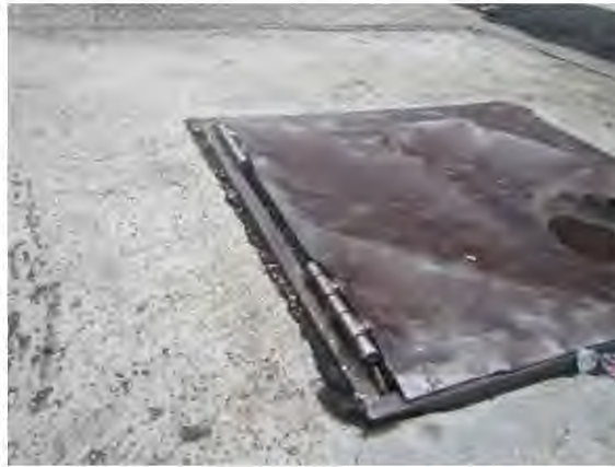
Fotografía 10. Tapa inadecuada. Fuente: Dioseline Camargo
