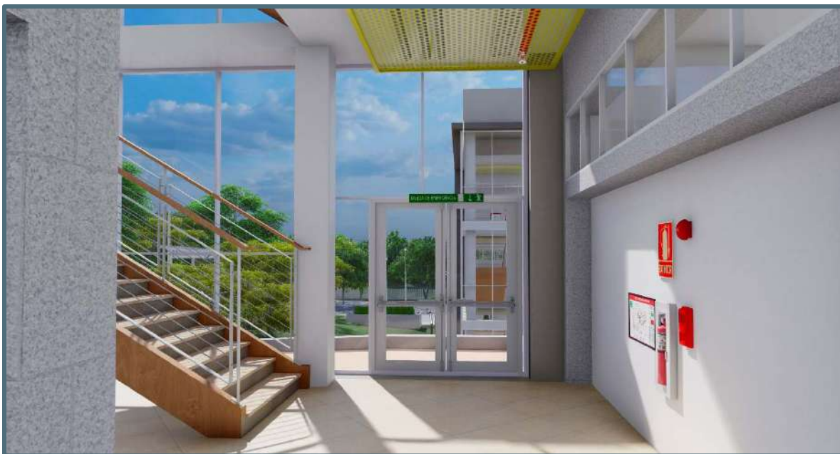
Imagen 64: Sistemas contra incendios, en la escalera este del edificio de Grado. Elaborado por el autor.
