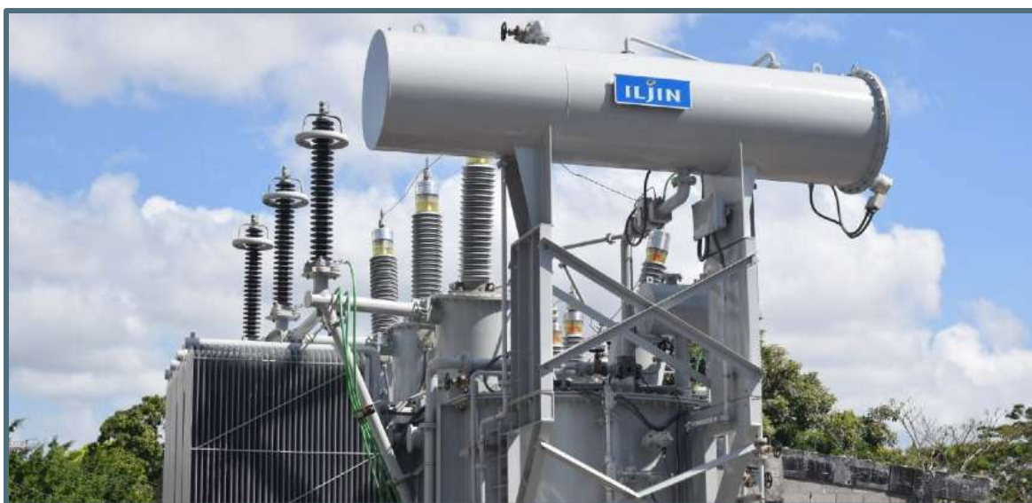
Imagen 34: En 2021 se modernizó la Sub-Estación de Santa María que beneficiará al corregimiento de Ancón.
