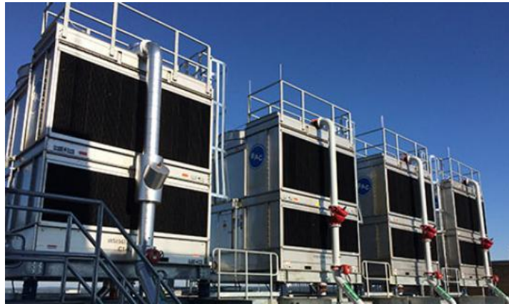
Figura 25: Torres de enfriamiento
