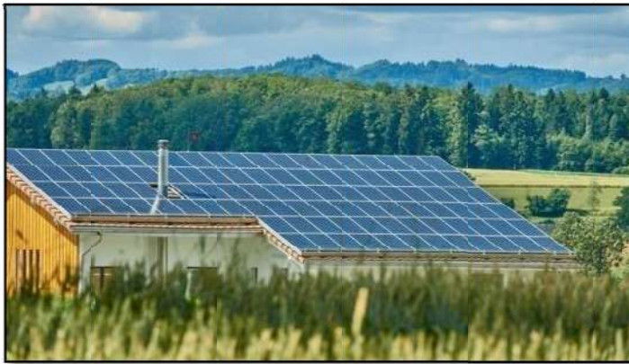
Ilustración 155-Paneles Solares en techos y tejados
