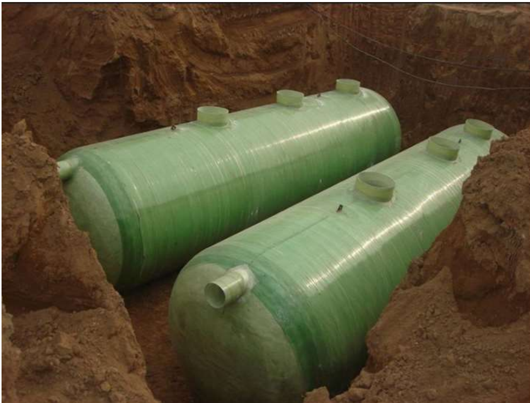
Figura 39 Tanque séptico FRP.
