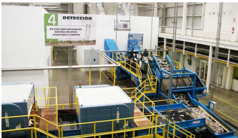
Figura 73: Pet Star, área de detección de material
