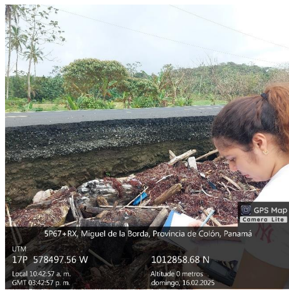
Figura 36 Evaluación de la socavación costera, medición y toma de coordenadas
