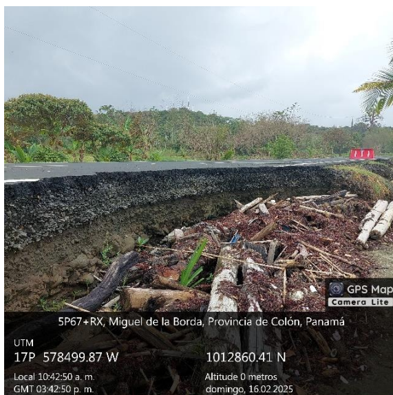
Figura 35 Socavación costera en la vía entre Miguel de La Borda y Gobe
