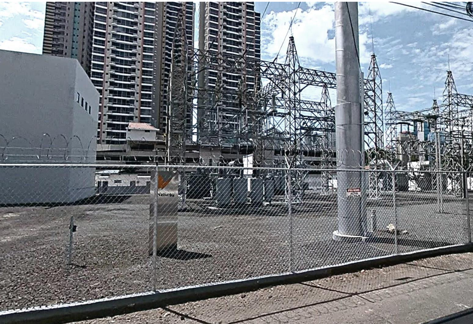
Ilustración 85: Subestación de distribución eléctrica de la empresa Naturgy dentro del Corregimiento de San Francisco.
