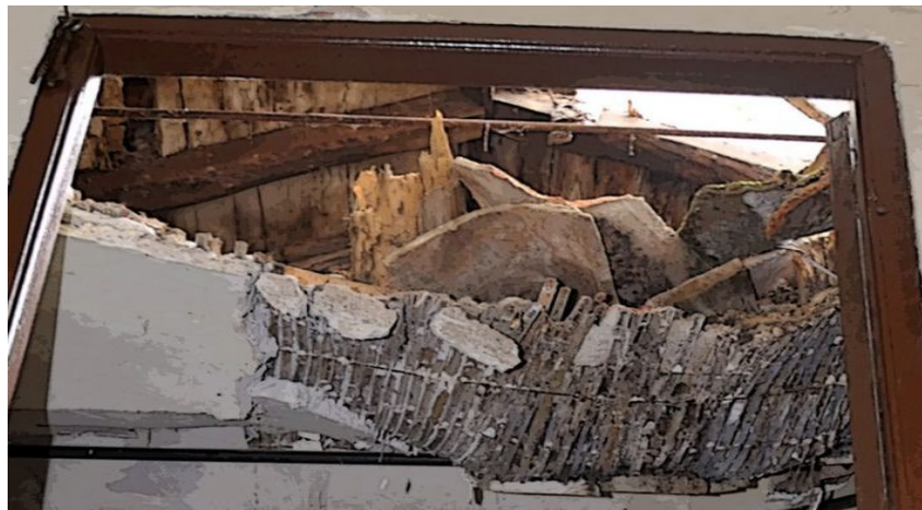
Figura. 24 Daños a Madera de una casa por los termites https://www.anticimex.es/termitas/danos/
