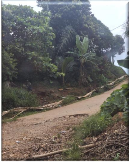
Tuberías de Agua Potable improvisadas
