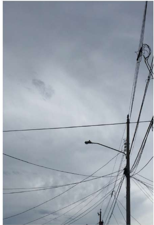
F.51. Típico cableado aéreo en urbanizaciones de la Ciudad de Panamá. Eileen Gisselle. ©.
