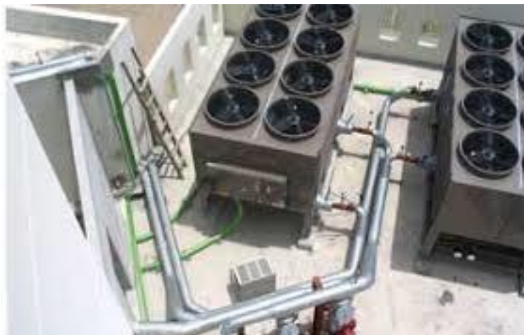
Ilustración 47: Sistema de aires acondicionados.
