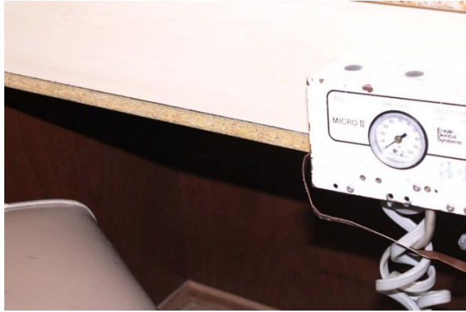
Imagen #19 Mal estado de todo las instalaciones del laboratorio
