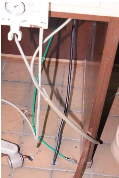
Imagen#18 Mal estado de instalaciones de aire y electricas en el Laboratorio FOUP
