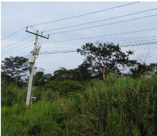
Ilustración 16 Poste de tendido eléctrico cercano al terreno
