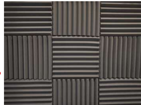
Recubrimiento acústico absorbente en espacios para práctica y estudio de instrumentos.
