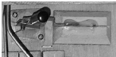
Figura 16. (Válvula de liberación de aire; fotografía por Alexander Boutet)
