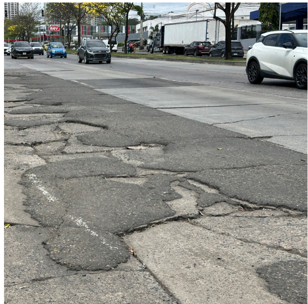
Figura 13. Estado de calles de la Ave. Simón Bolívar. Elaboración propia.
