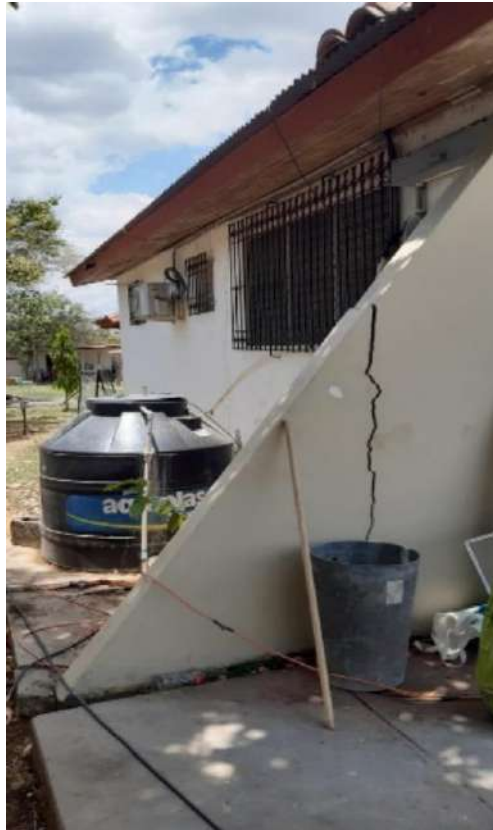
Figura 18: Grietas en muros externos, parte posterior del edificio
