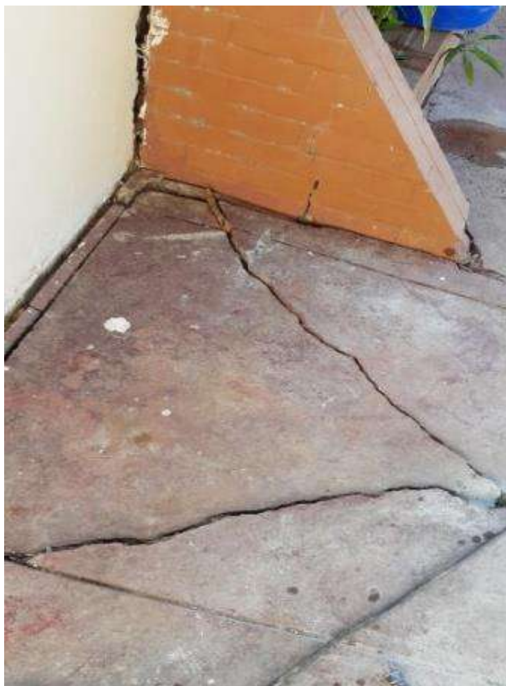
Figura 16: Vista de la fisura del piso lateral, parte posterior de edificio
