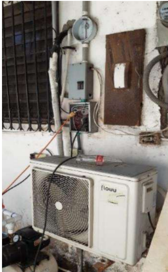
Figura 17: Sistema eléctrico y aire acondicionado en mal estado, parte posterior del edificio.
