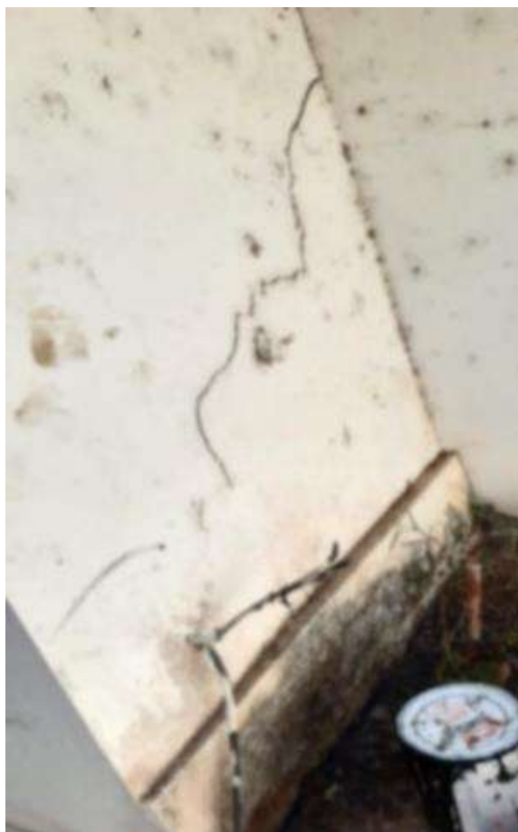
Figura 12: Vista de pared con fisura parte posterior del edificio
