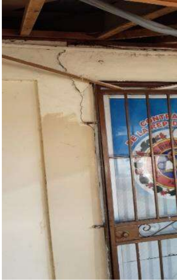
Figura 14: Vista de pared y puerta con grietas en la parte posterior del edificio
