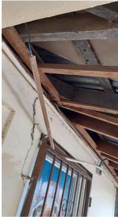
Figura 13: Vista del deterioro del techo y estructura en la parte posterior
