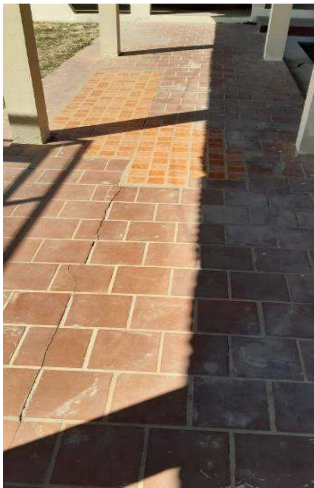
Figura 15: Vista del desgaste en el pasillo de conexión, parte posterior
