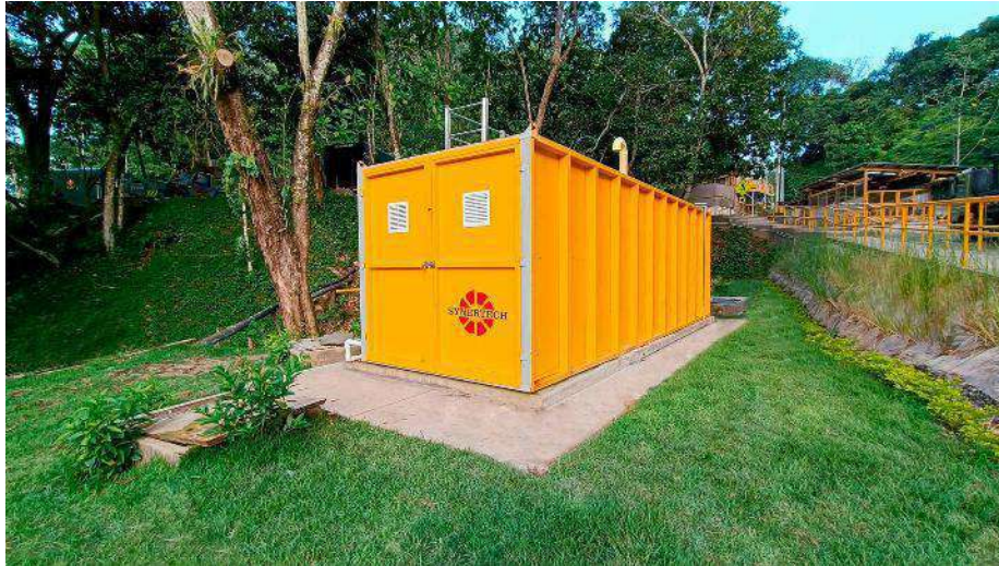
Figura 25. Imagen referencial de la PTAR
