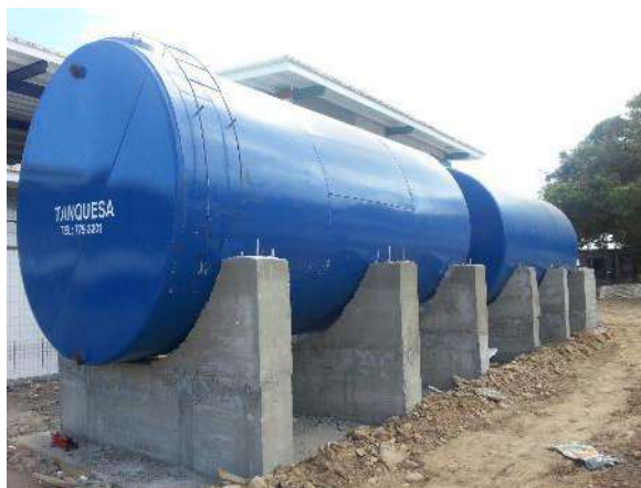
Figura 26. Modelo de tanque de reserva de agua
