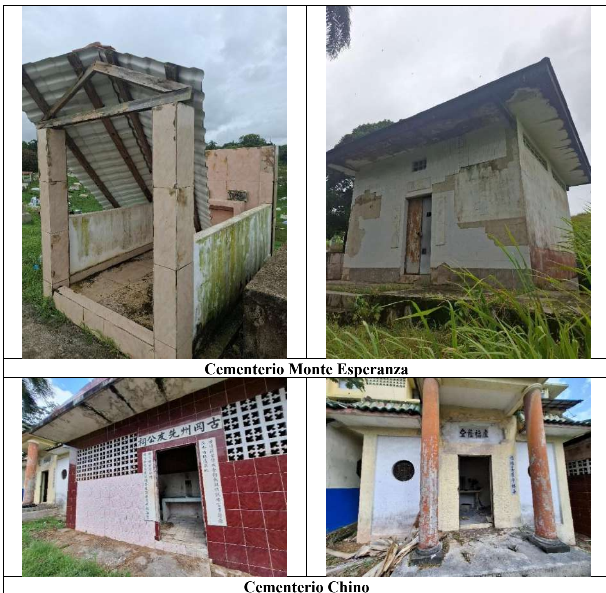
Ilustración 4. Mausoleos con deterioro estructural.
