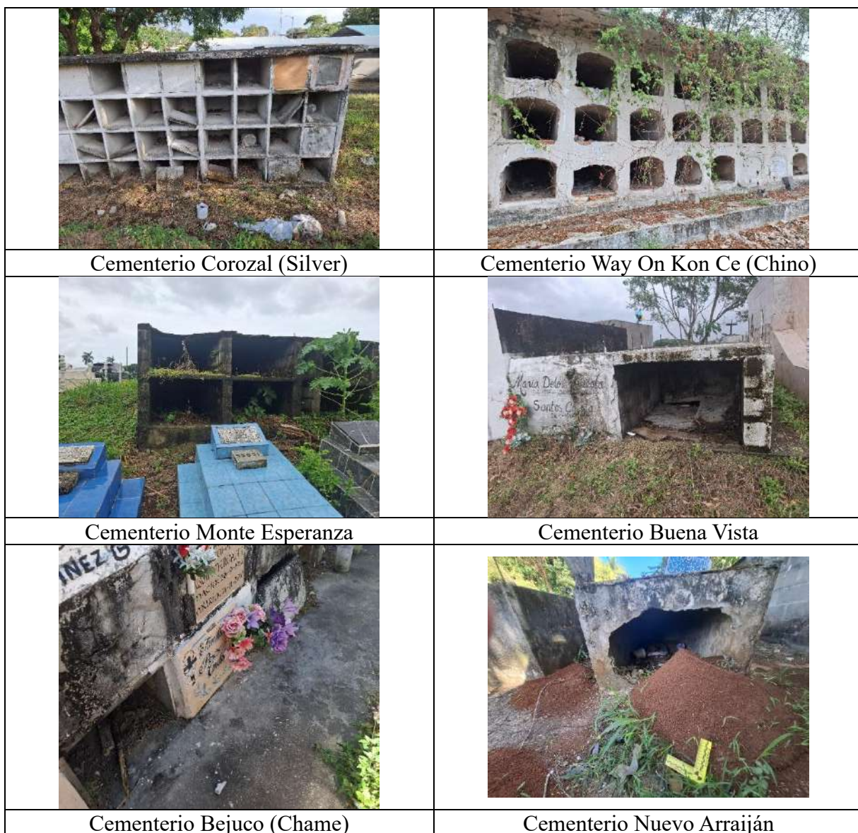
Ilustración 7. Nichos columbarios dañados y en deterioro.
