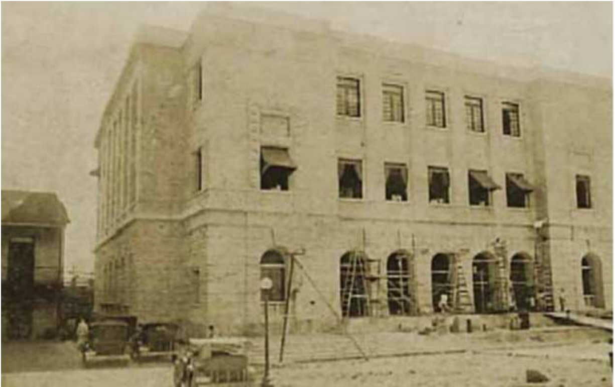
Figura 19: Etapla constructiva del Palacio de Justicia. Fuente: Órgano Judicial (2015). Informe de Gestión. Órgano Judicial, (p. 80).
