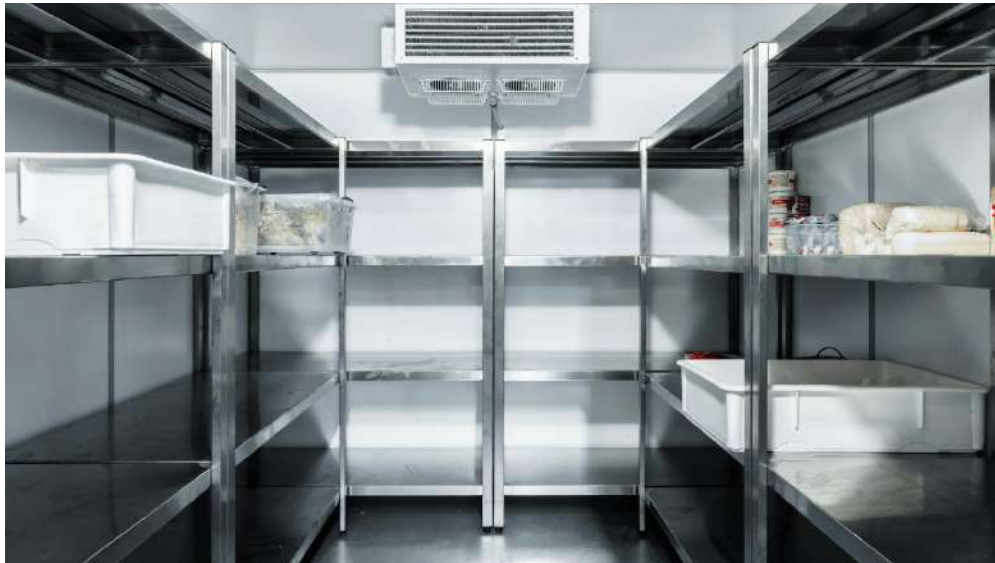
Ilustración 7 Área interior de cuartos fríos
