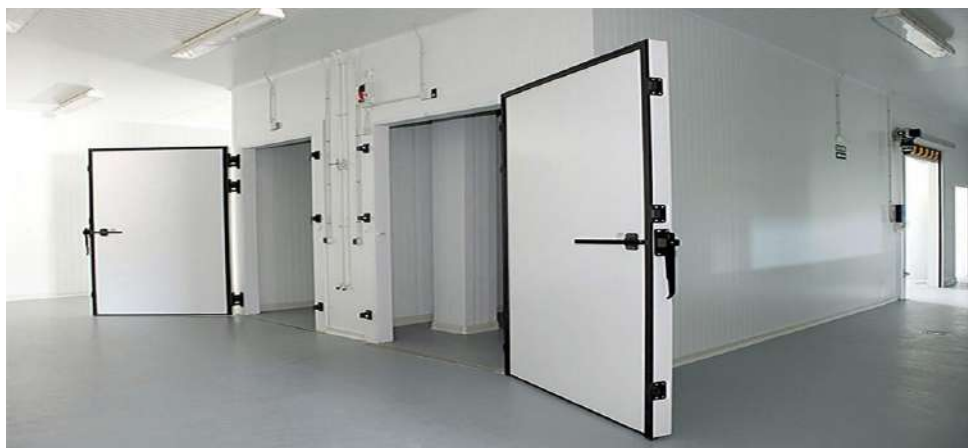
Ilustración 8 Área exterior de cuartos fríos
