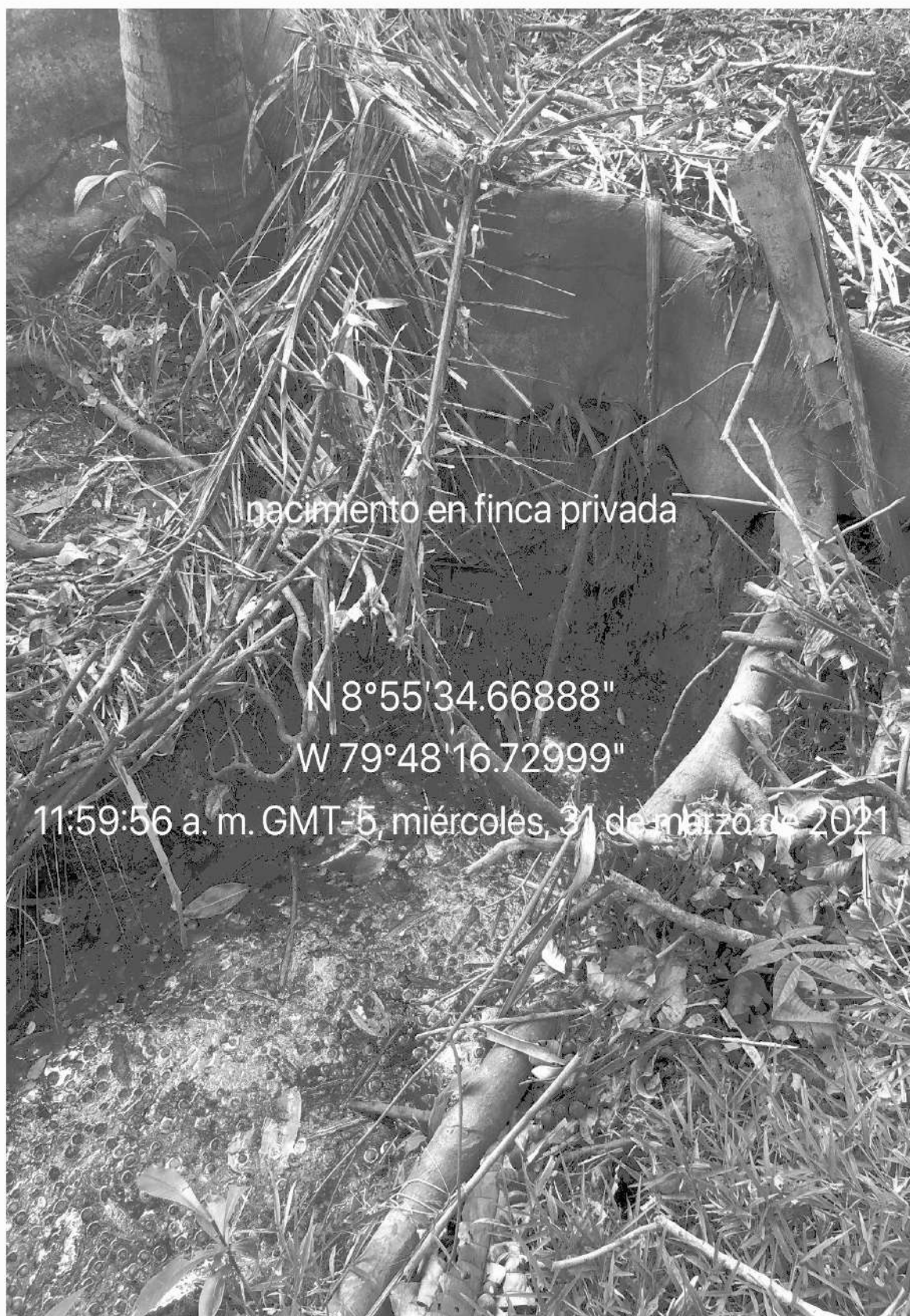
Ilustración 27. Dentro de una finca privada se encontró obstrucción del cauce.
