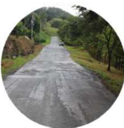
Imagen 20: Mal estado de las carreteras.
