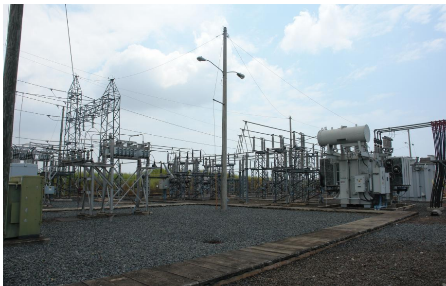
Figura 26. Subestación de electricidad Tocumen, Fuente: ENSA Panamá, 2020
