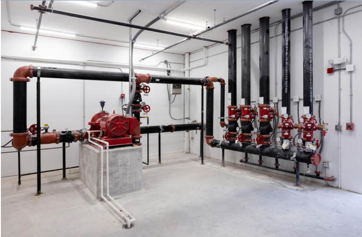
Figura 48. Sistema de bombeo de presión constante para centro de salud.
