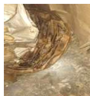
Ilustración 100. Capa de moho que se formó sobre la capa de engrudo.
