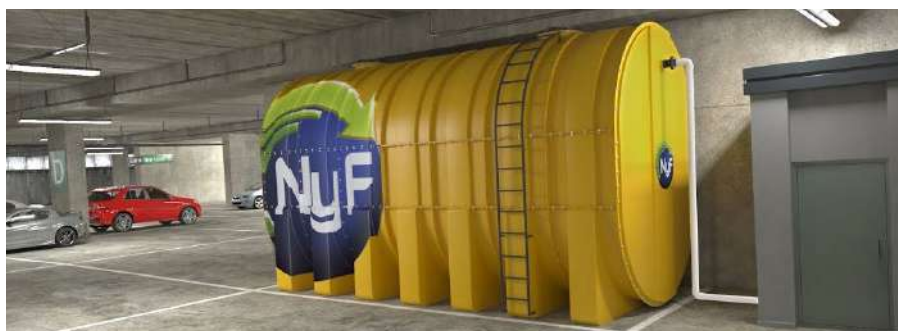
Imagen 98. Tanque de agua © Synertech
