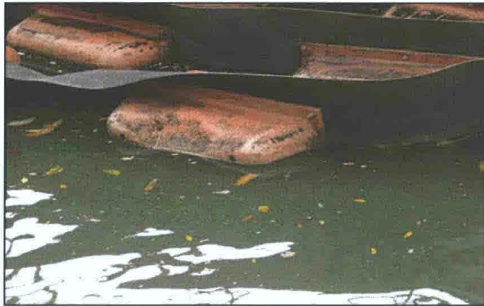
Figura 14. Toma de agua de Paraíso, coloración verde en el agua (10 de octubre de 2008)
