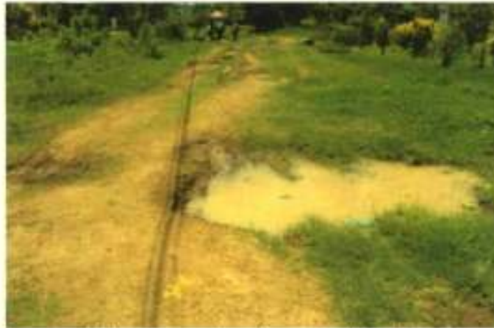
Carretera de tierra en mal estado, cerca a las viviendas y donde transitan los carros, animales, peatones, etc.
