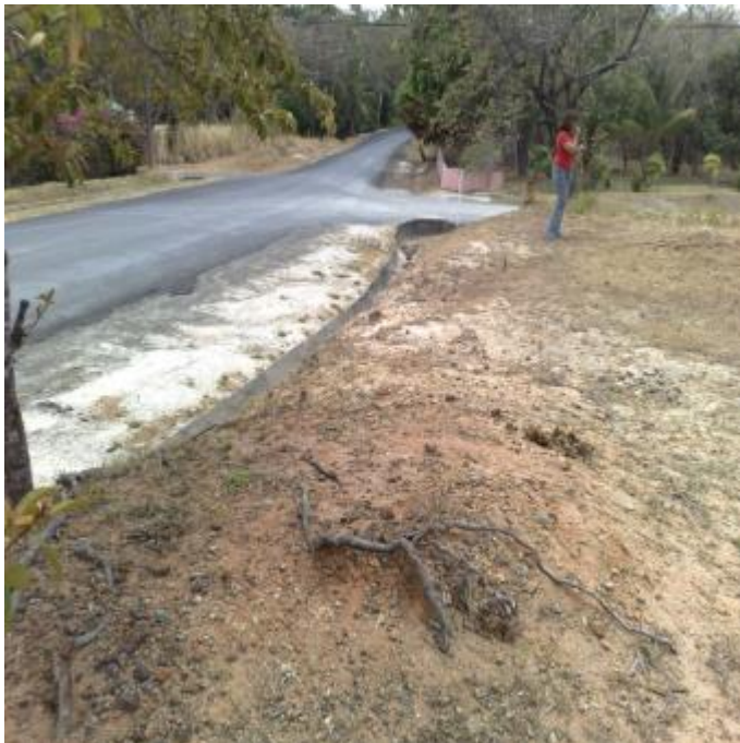
Ilustración 3 Falta de Aceras y calles básicas
