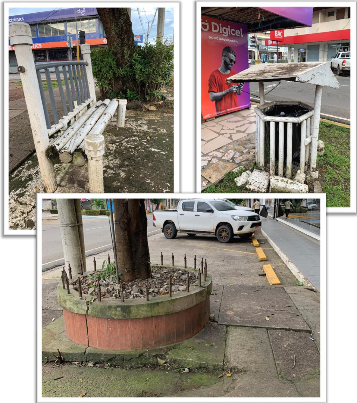
Figura #22: La Avenida Central, posee áreas para descansar y árboles en mal estado.
