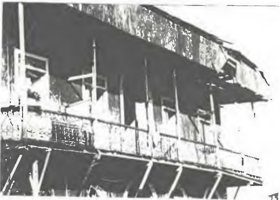
12 Vivienda condenada en avanzado estado de deterioro, en cuyos cuartos vive un número considerable de pacientes de Tercera Edad.
