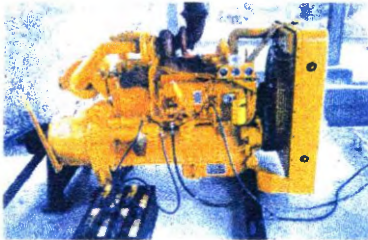
Fig. N° 12 Puesto de bombas. Bombas y Motores 3306B
