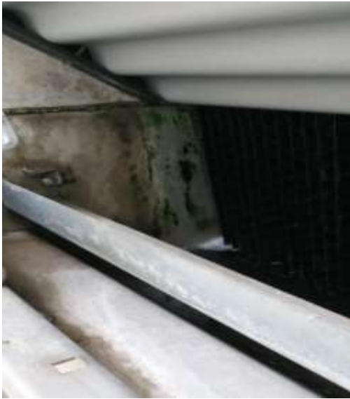
Biofilm incrustado en las torres de enfriamiento, contribuye al crecimiento y protección de la Legionella pneumophila
