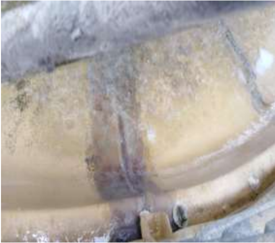
Biofilm incrustado en las torres de enfriamiento, contribuye al crecimiento y protección de la Legionella pneumophila
