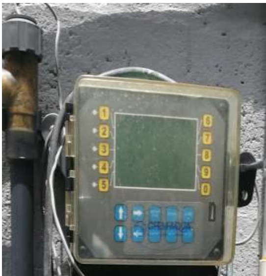
Dosificadores automáticos de biocidas están dañado. Torres con ausencia de un biocida.
