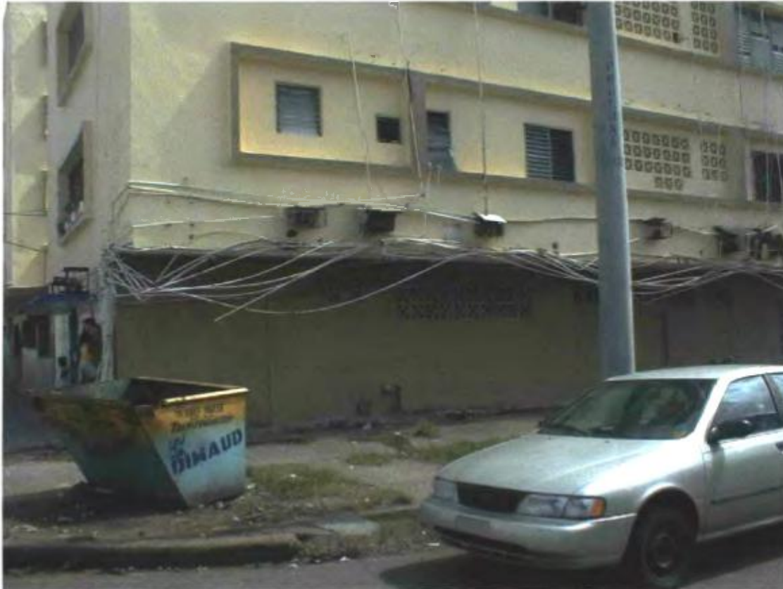
Fig. 1. Redes de tuberías de agua con la presencia de bombas de agua y desperdicios de basura. Ciudad de Colón
