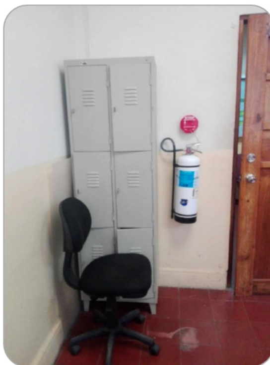
Imagen N° 3. Extintor y casillero en el Laboratorio. Fuente: Himera Bethancourth.
