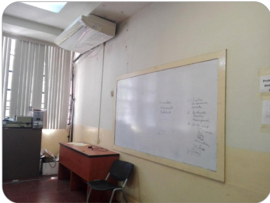
Imagen N° 6. Aire Acondicionado, tablero y escritorio del Laboratorio. Fuente: Himera Bethancourth.
