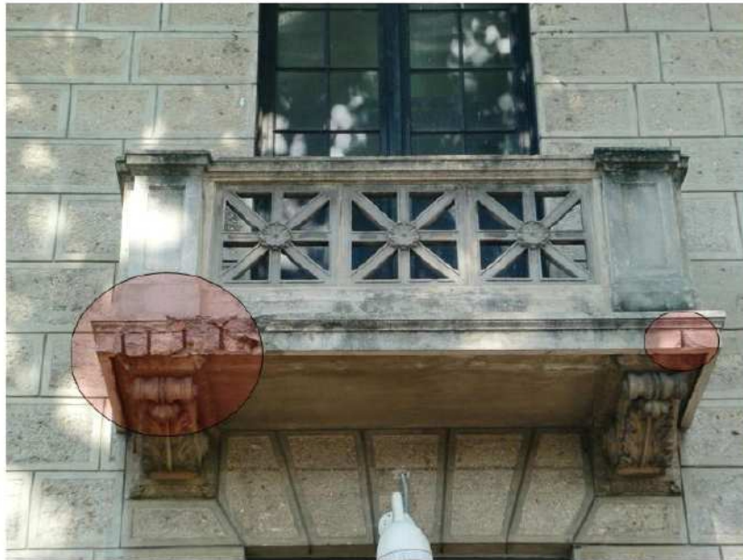
Imagen 53: Exposición del acero producto de la humedad, lo que hacemos público una pronta intervención. Fuente: Foto de R. Cerón-C.
