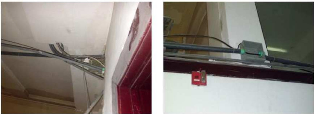
Imagen 28: Vemos el Split y sobre el todo un intrincado de tuberías eléctricas, mientras en su parte baja apreciamos paneles eléctricos. Fuente: Foto de R. Cerón-C.
