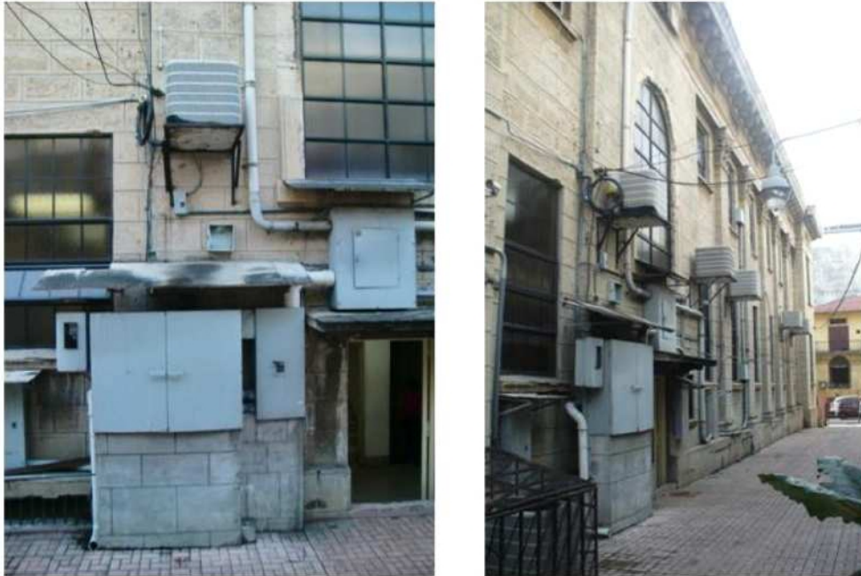
Imagen 26: Se aprecia como el sistema eléctrico como el sistema de Split ha saturado la pared posterior. Fuente: Foto de R. Cerón-C.
