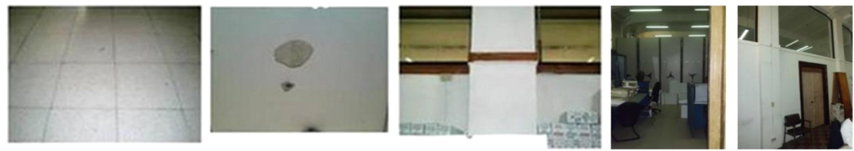
Pavimentos cerámicos no originales, desprendimientos de cielo raso y detalles de molduras.
