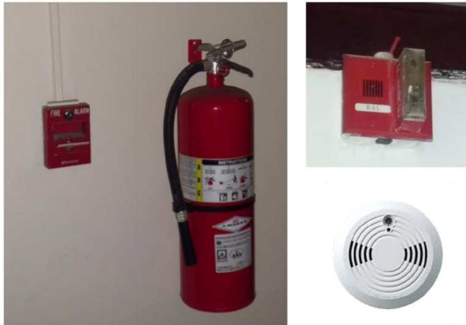
Imagen 25: Extintores, sistema manual, detector de calor y detectores de humo. Fuente: Foto de R. Cerón-C.
