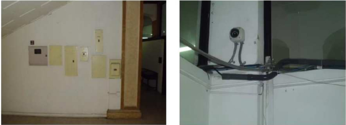
Imagen 29: Tuberías eléctricas, cámaras de video, lámparas de pasillo instalaciones fuera de contexto. Fuente: Foto de R. Cerón-C.
