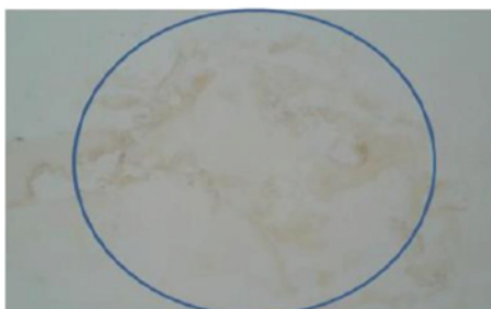
Manchas de humedad en cielo raso
