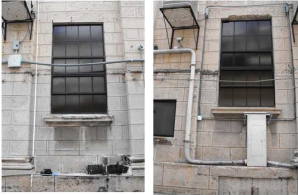
Imagen 27: Sistema eléctrico improvisado. Fuente: Foto de R. Cerón-C.
