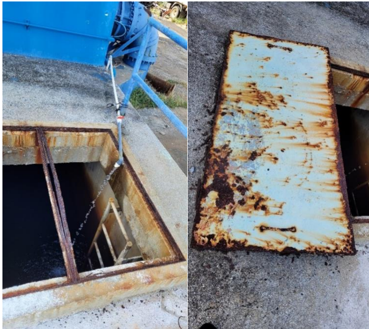
Fig. 12. Puertas oxidadas y a la intemperie de tanque de almacenamiento de la Planta Potabilizadora Centenario de Pacora.
