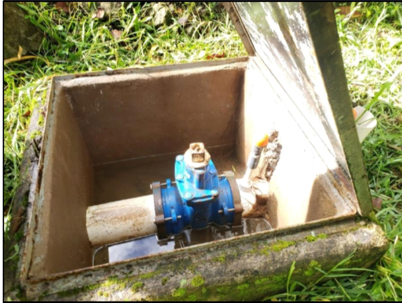
Válvula para control de flujo, Acueducto Rural Monte Lirio
