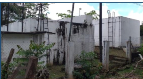
Tanques de almacenamiento
