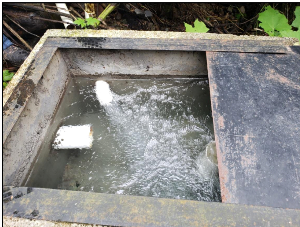
Toma de agua, Jaarpan, Finca Morgan, estructura de captación
