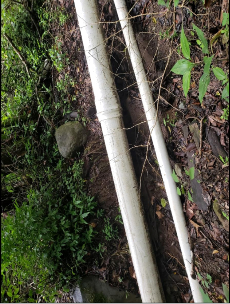
Línea de conducción, antigua tubería de 10" y actual de 4", Acueducto Rural de Río Sereno
