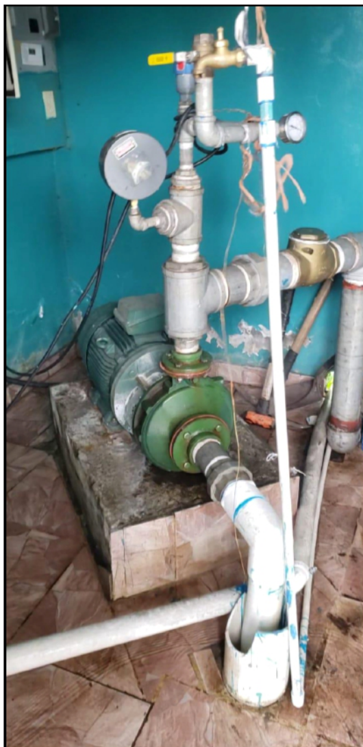
Estación de bombeo, Jaarpan, Vía hacia Hotel Bambito, Paso Ancho, Prov. de Chiriquí
