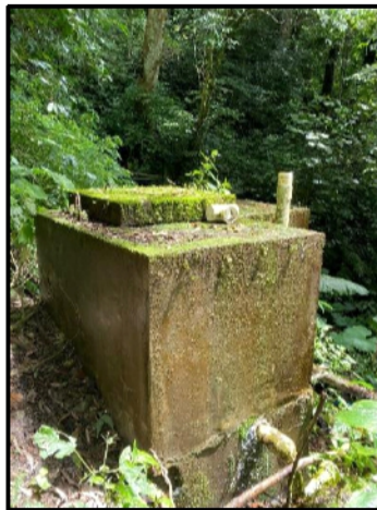
Tanque de almacenamiento, Toma de agua próxima a Hotel Casa Grande.
