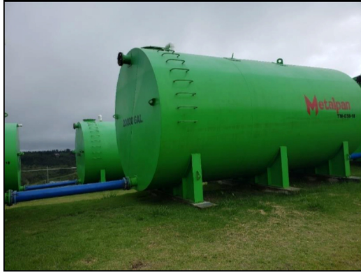
Tanque de almacenamiento, Acueducto Rural de Río Sereno.
