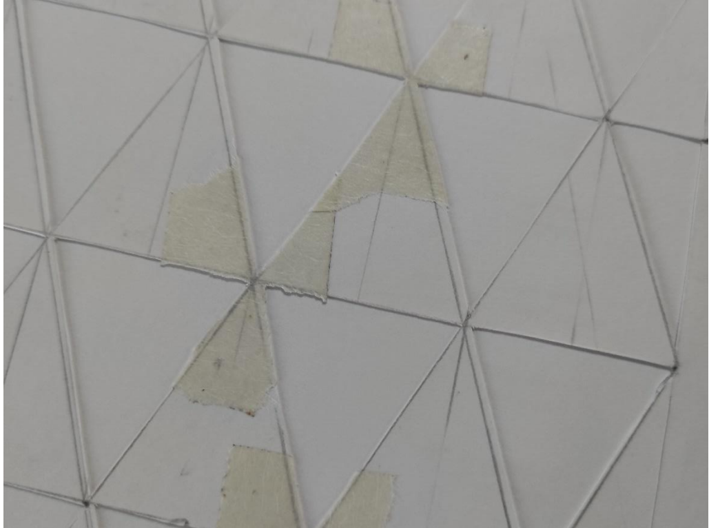
Ilustración 78. Reparación realizada con maskingtape
