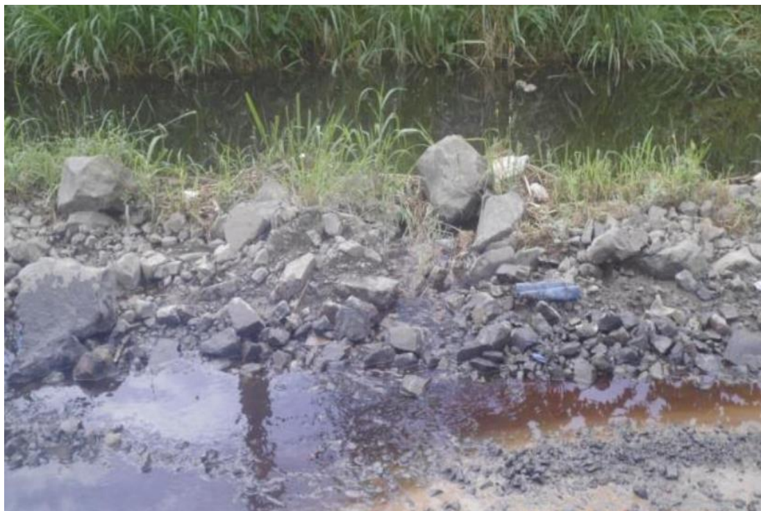
Anexo 13: Lixiviados y aguas residuales, en los perímetros del vertedero.
