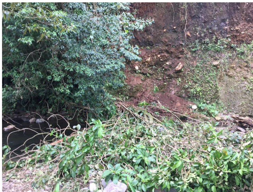
Parcela 2. Socavación extrema, derrumbes y arrastre de sedimentos.
