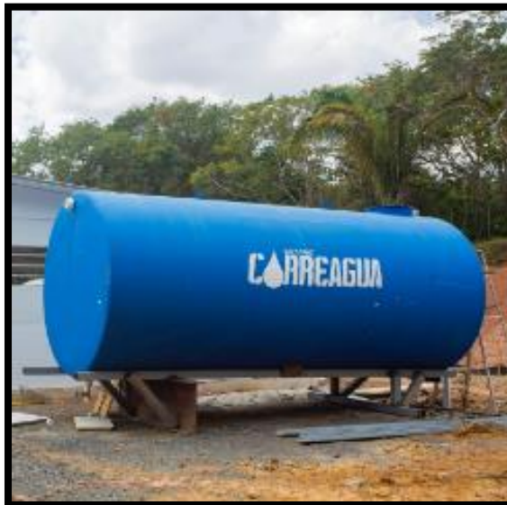
Ilustración 41: Tanque de reserva de agua
